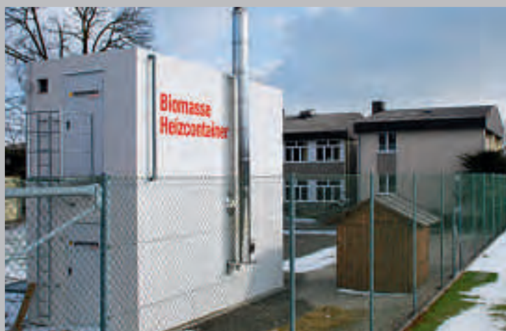
Doppelstock-Hackgut-Heizcontainer neben einer Schule.
